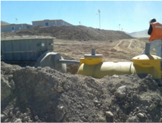
Clorador y dechlorador con tubos de acceso a los Porta-Pastillas
