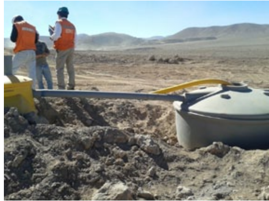
Estanque de acumulación de agua tratada
